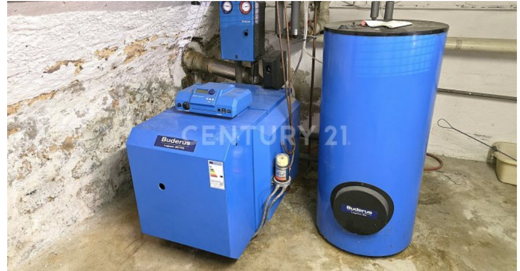
Öl - Zentralheizung Buderus mit Warmwasserspeicher Bj. 2005
