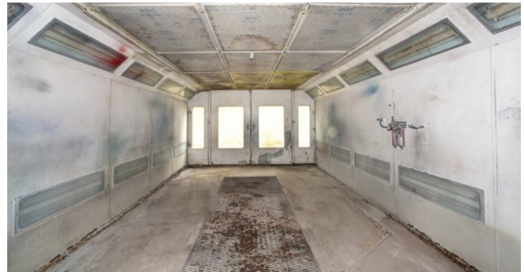
ehem. Lackierkabine 2. UG
