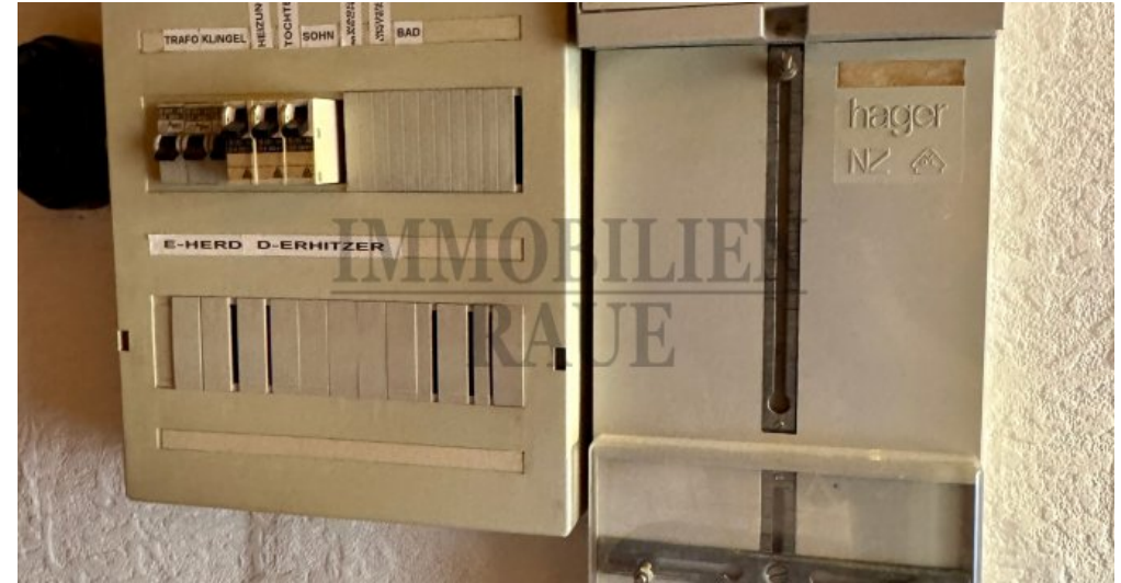
Unterverteilung im DG
