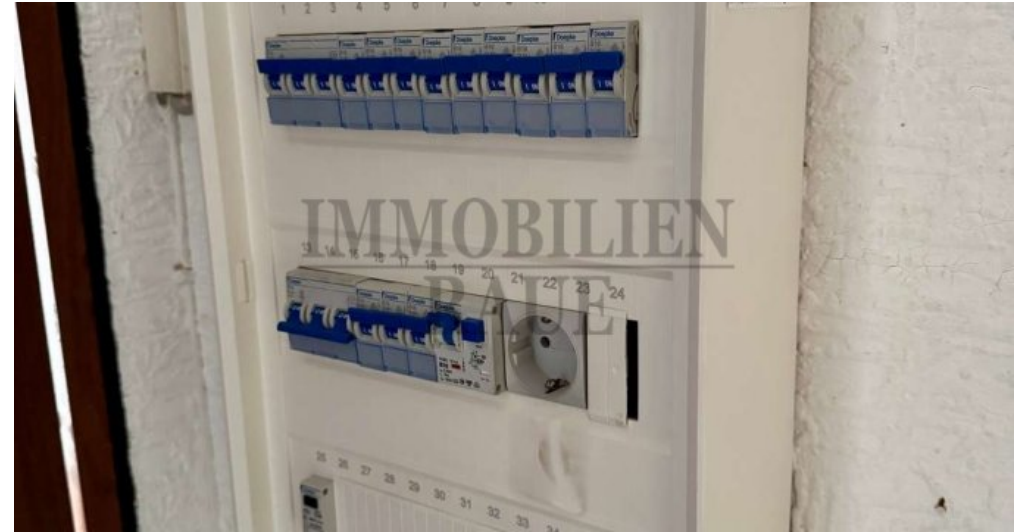
Unterverteilung im EG
