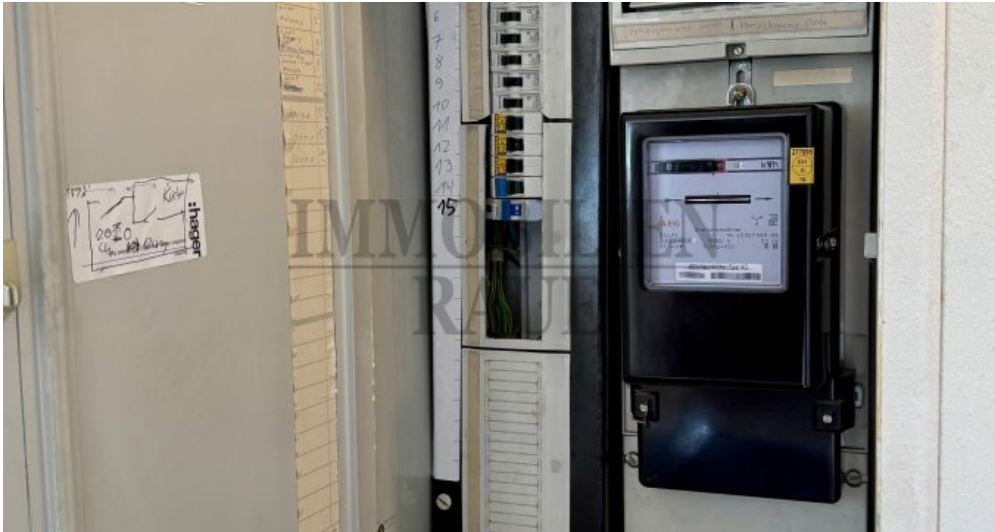
Stromzählerschrank im KG
