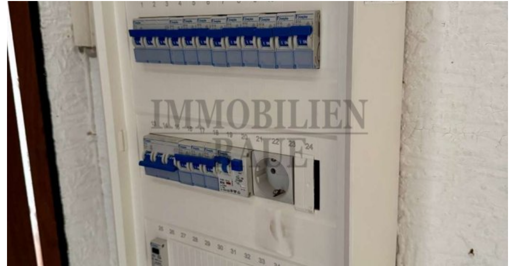
Unterverteilung im EG
