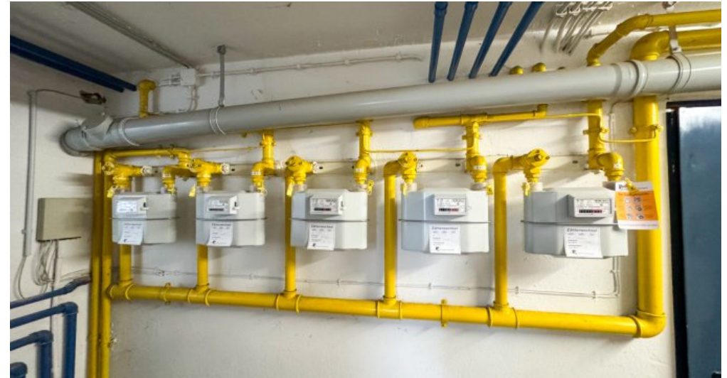
Gaszähler im Keller
