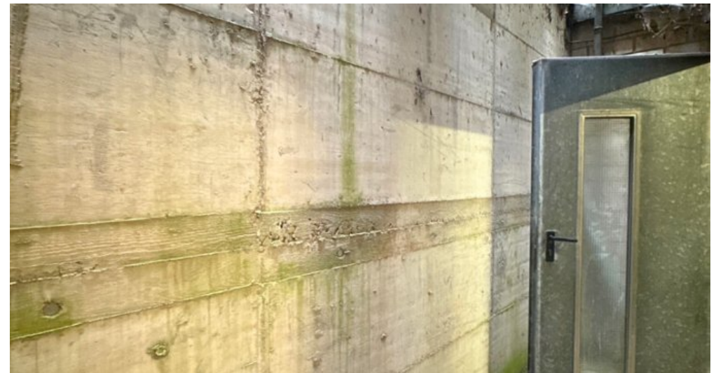
Verbindungsstück zum Heizungsraum EG
