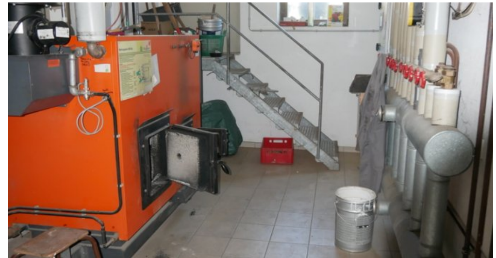
Heizungsanlage mit Hackschnitzel
