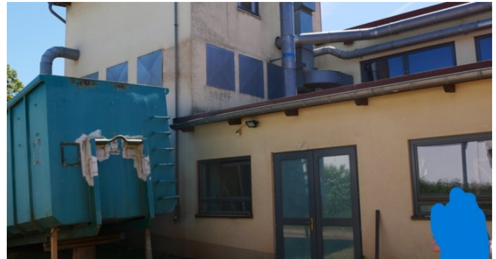
Hackschnitzelanlage und Spänesilo
