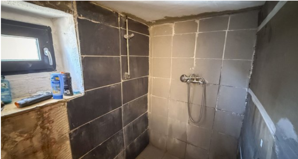
Keller provisorische Dusche
