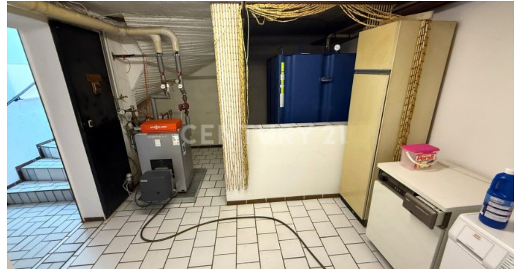
Waschküche mit Ölheizung (2006) + Tanks
