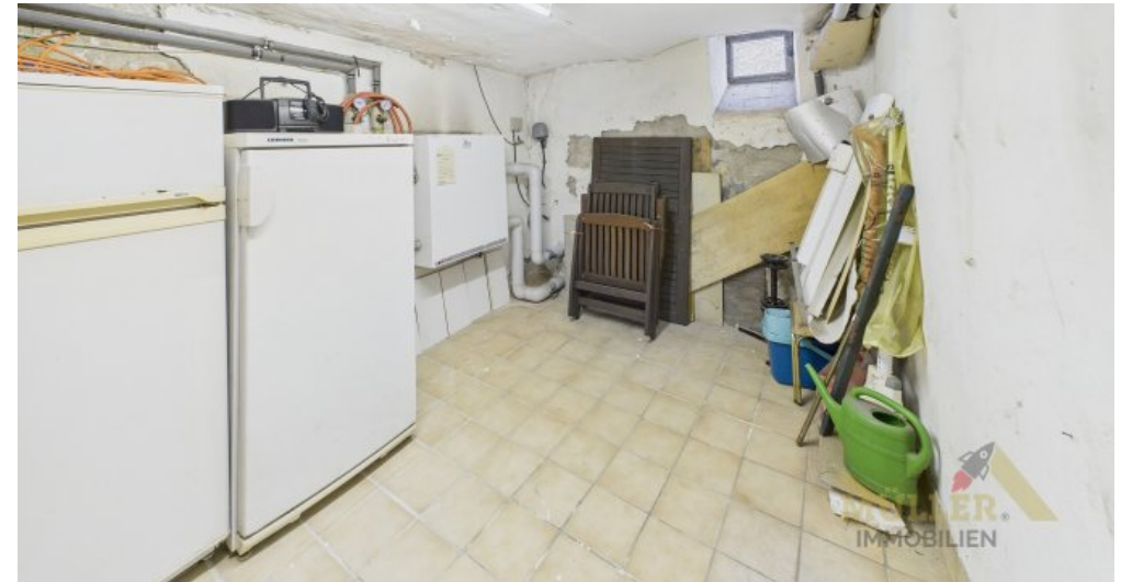
Kellerraum 2 mit Heizung
