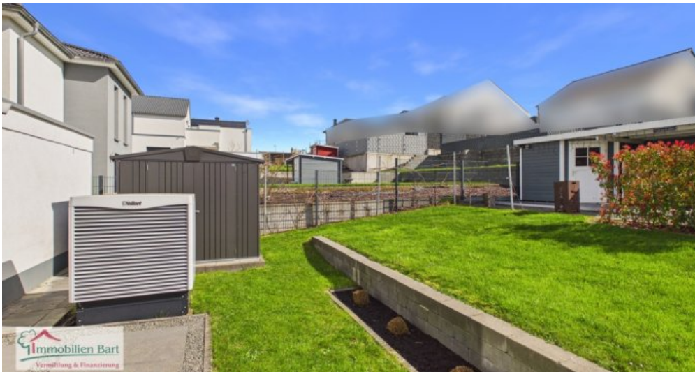
Wärmepumpe und Gartenhaus
