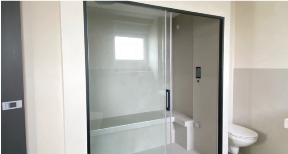
Dusche mit Dampfbad
