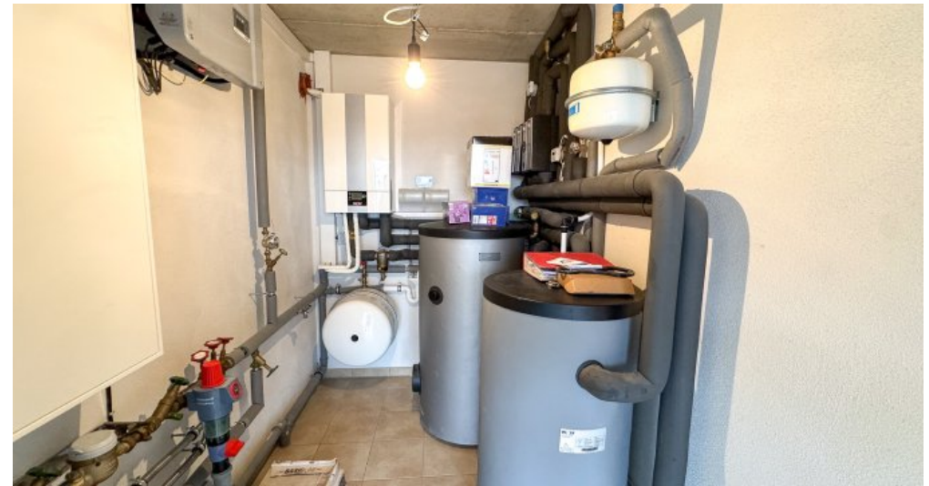
Hautechnikraum mit Luft-Wasser-Wärmepumpe
