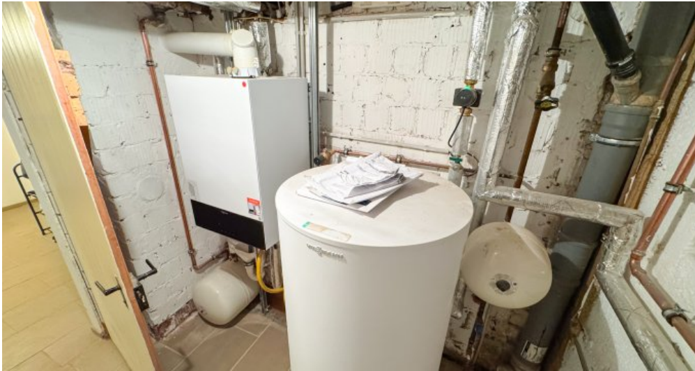
Gasbrennwertheizung mit Warmwasserspeicher
