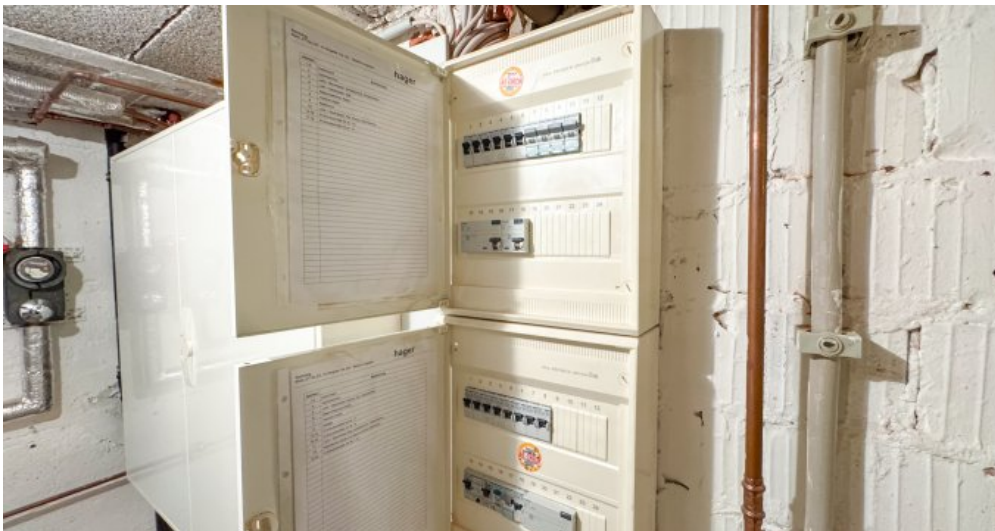
Separate Unterverteilung Strom
