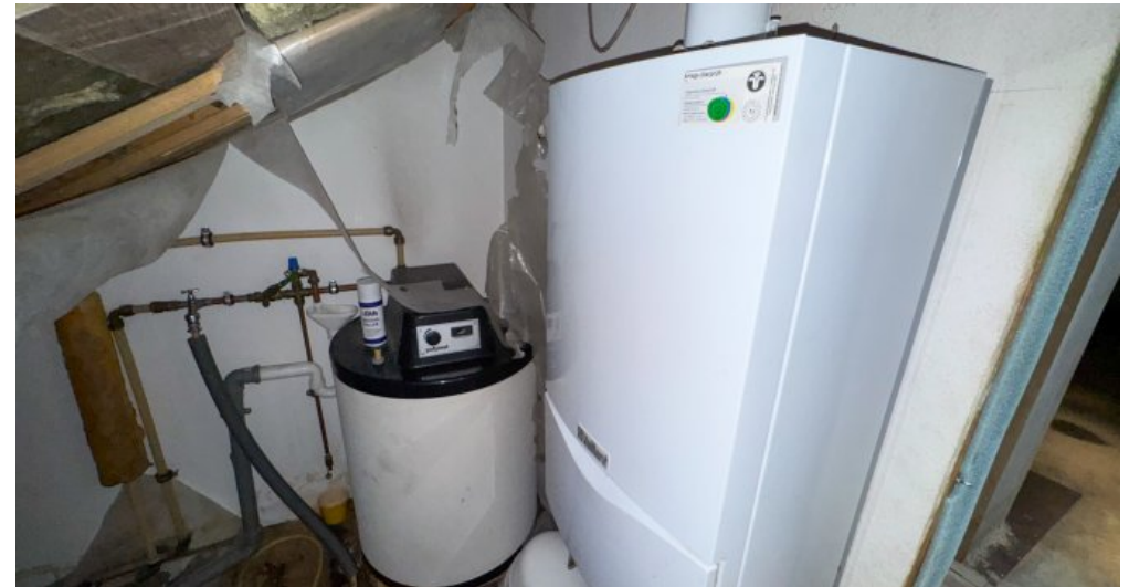
Heizung unterm Dach
