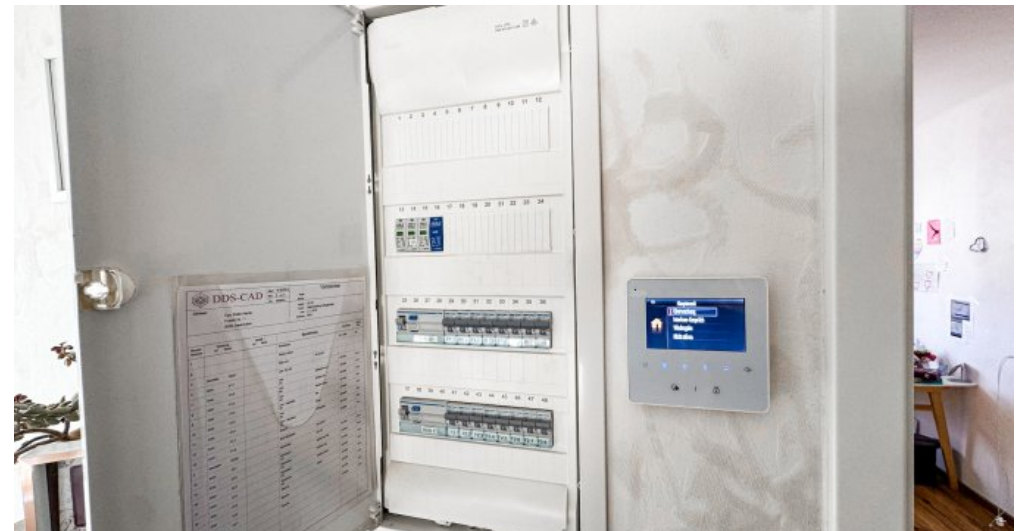
Unterverteilung Strom OG&DG
