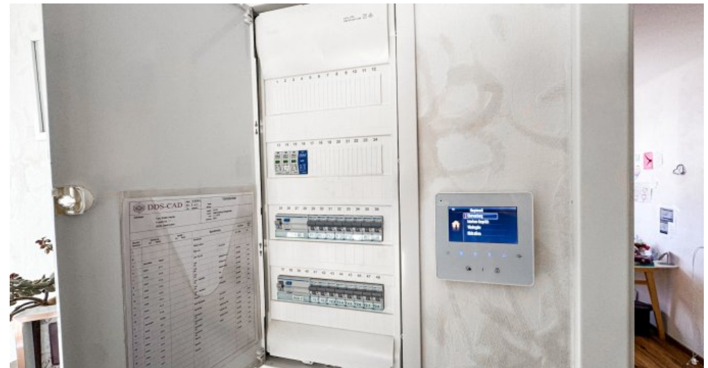
Unterverteilung Strom OG&DG
