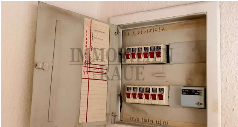
Sicherungskasten in der Whg.
